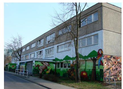
Das 30 Jahre alte Kitagebäude war stark sanierungsbedürftig
