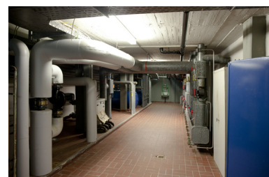
Abb. 43 - Stadtbad TH / Technikbereich
