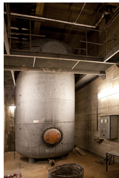
Abb. 42 - Stadtbad TH / Technikbereich
