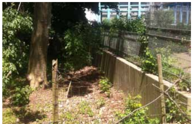
Abb. 20 Winkelstützen als Hangsicherung
