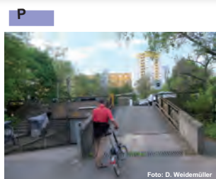
Obstallee: sanierungsbedürftiges Parkdeck
