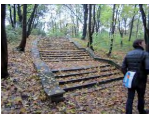
Treppenanlage mit Barrierewirkung
