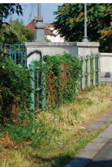
Erneuerungsbedarf am Kiehlufer © BSM mbH
