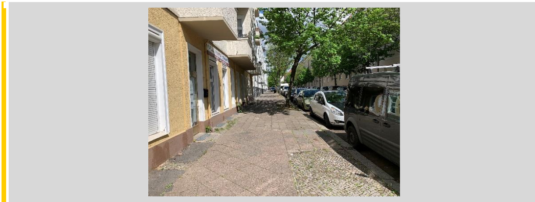
Abbildung 1.14: Gehwegschäden in der Rudolf-Reusch-Straße
