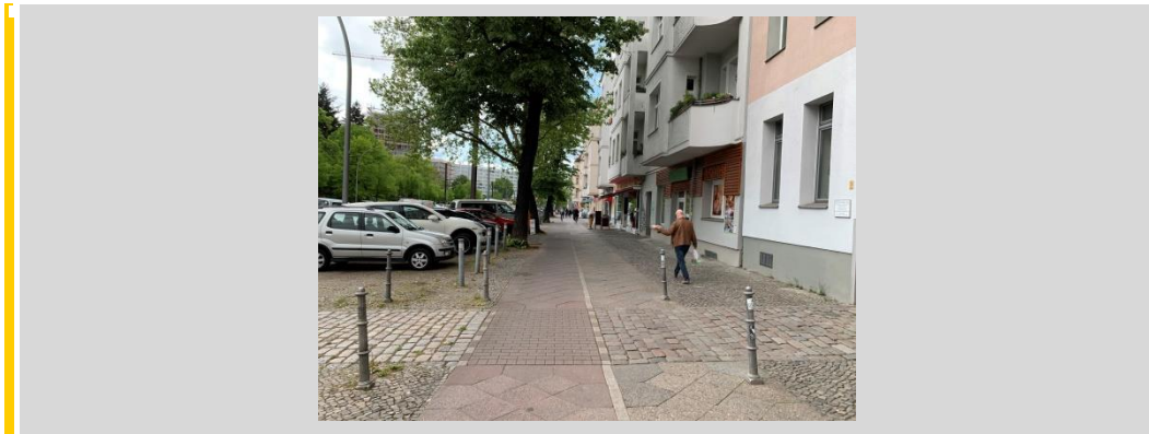
Abbildung 2.5: Radwegschäden in der Möllendorffstraße
