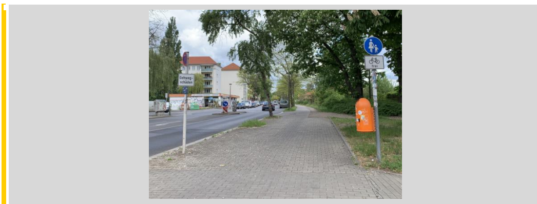
Abbildung 1.15: Gehwegschäden in der Ruschestraße
