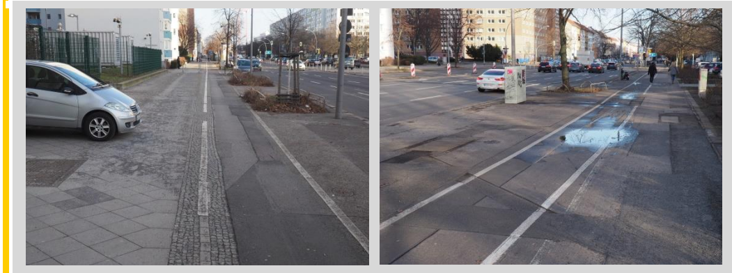
Abbildung 2.4: Radwegschäden in der Frankfurter Allee
