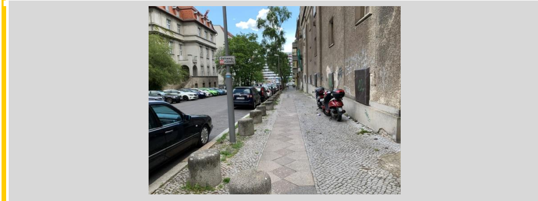
Abbildung 1.16: Gehwegschäden in der Hubertusstraße
