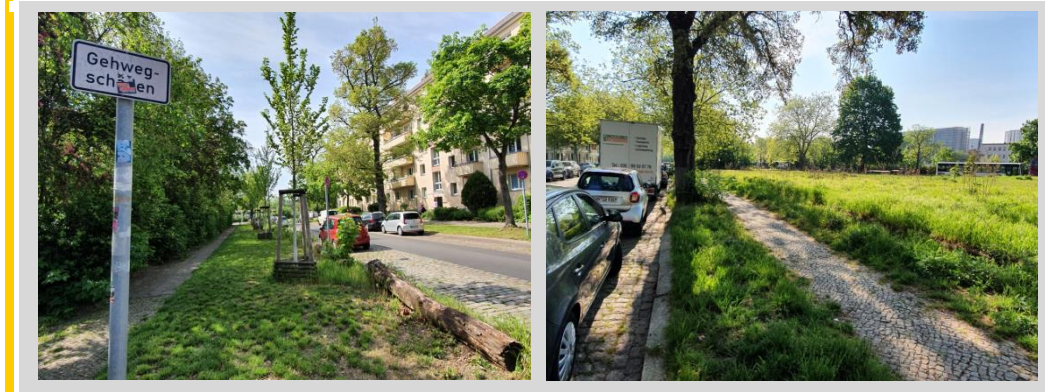
Abbildung 1.18: Gehwegschäden in der Kriemhildstraße (links) und in der Rüdigerstraße (rechts)
