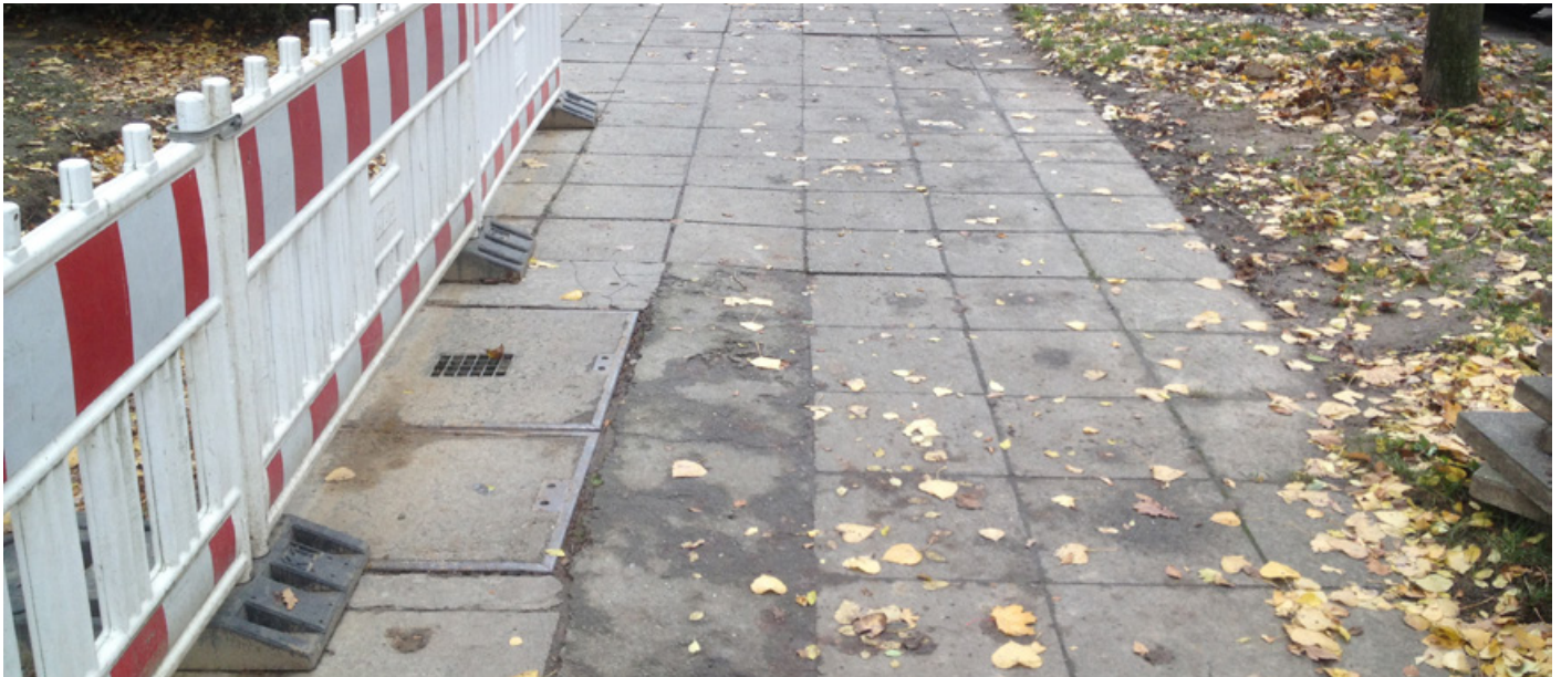
© STATTBAU GmbH: Gehwegschäden an der Gotlindestr. 67-77 | 2016
