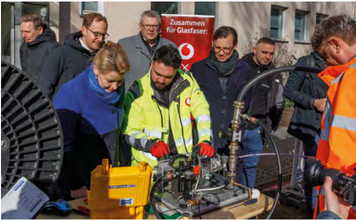
Die Wirtschaftssenatorin Franziska Giffey zeigte sich am 29.2. hoch erfreut über den Start der Glasfaser-Initiative im Charlottenburger Norden. Mit dabei Stefan Rüter (OXG), Dirk Enzesberger (Charlottenburger Baugenossenschaft) und Michale Jungwirth (Vodafone) 2. Reihe von links.
