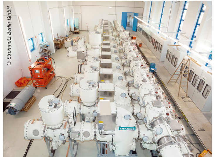
In der Schalt-Anlage des Netzknotens. Hier wird Hochspannung verteilt
