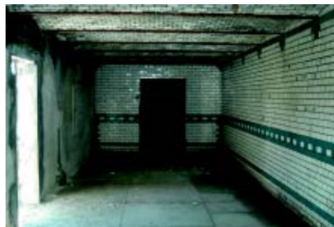
oben: Eindrücke von der unsanierten Doppelkaianlage am Gröbenufer
